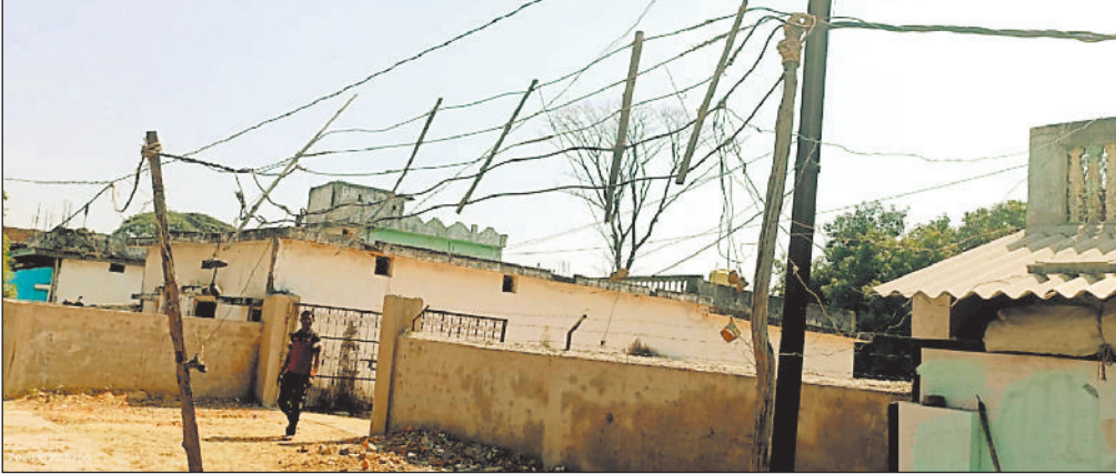
बांस बल्ली के सहारे बिजली सप्लाई।
